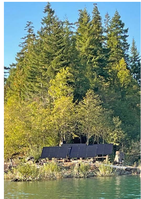
Paneles solares en el Lago Daisy
